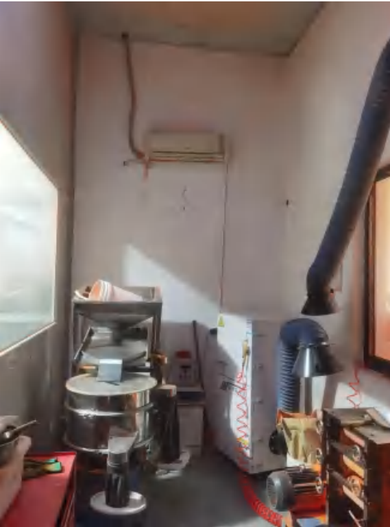
氮化物出粉块、粉碎间（集气罩+滤筒除尘器）
