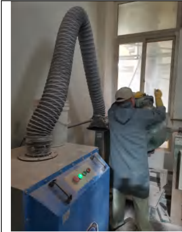
氮化物混料间
