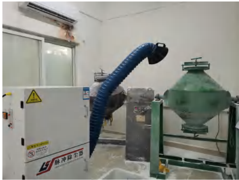
5#硅酸盐混料间（集气罩+滤筒除尘器）
